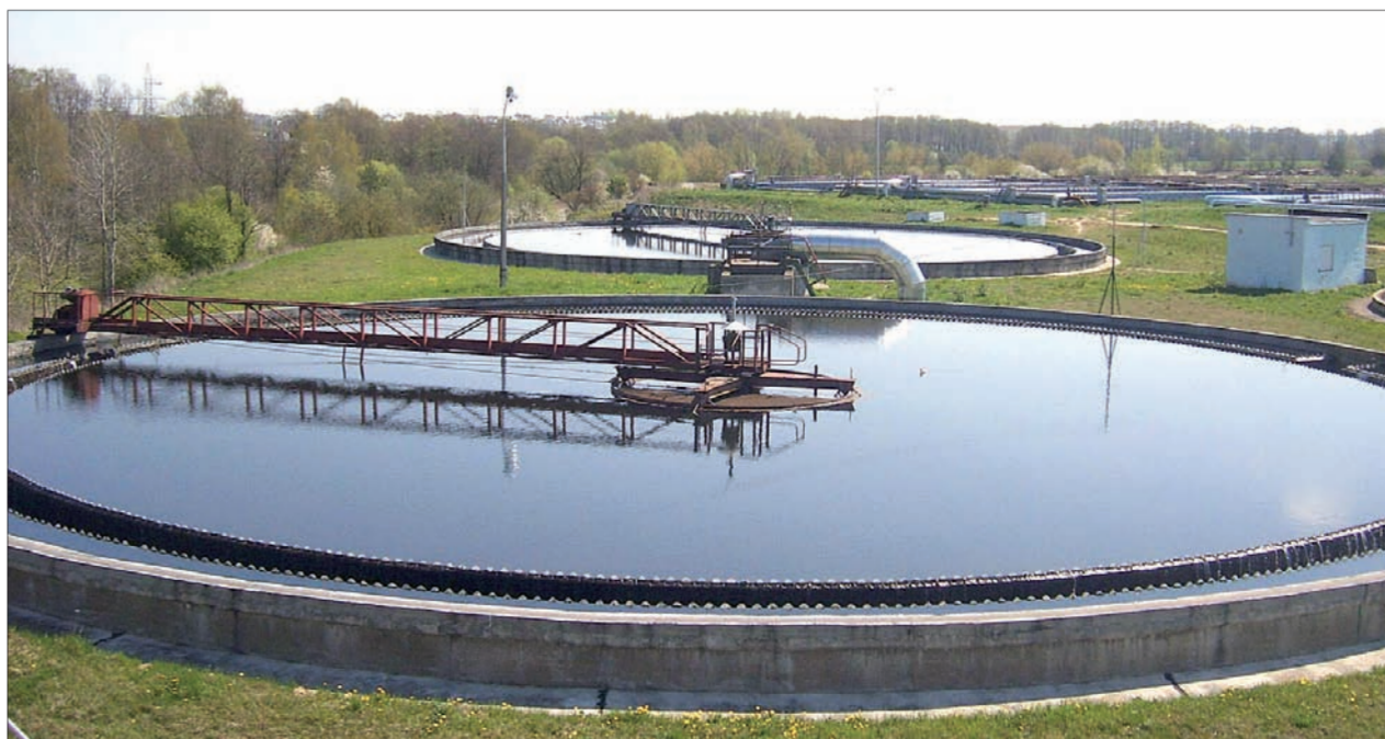
Очистные сооружения канализации
